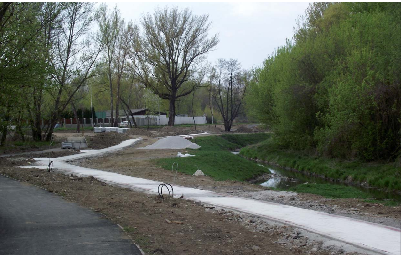
▲ Ešte nedokončené a neupravené chodníky pre cyklistov a peších pri potoku (apríl 2011). The paths for bikers along the stream still not finished and surfaced (April 2011). Die noch nicht vollendeten und gestalteten Wege für Radfahrer und Fußgänger am Bach (April 2011).
