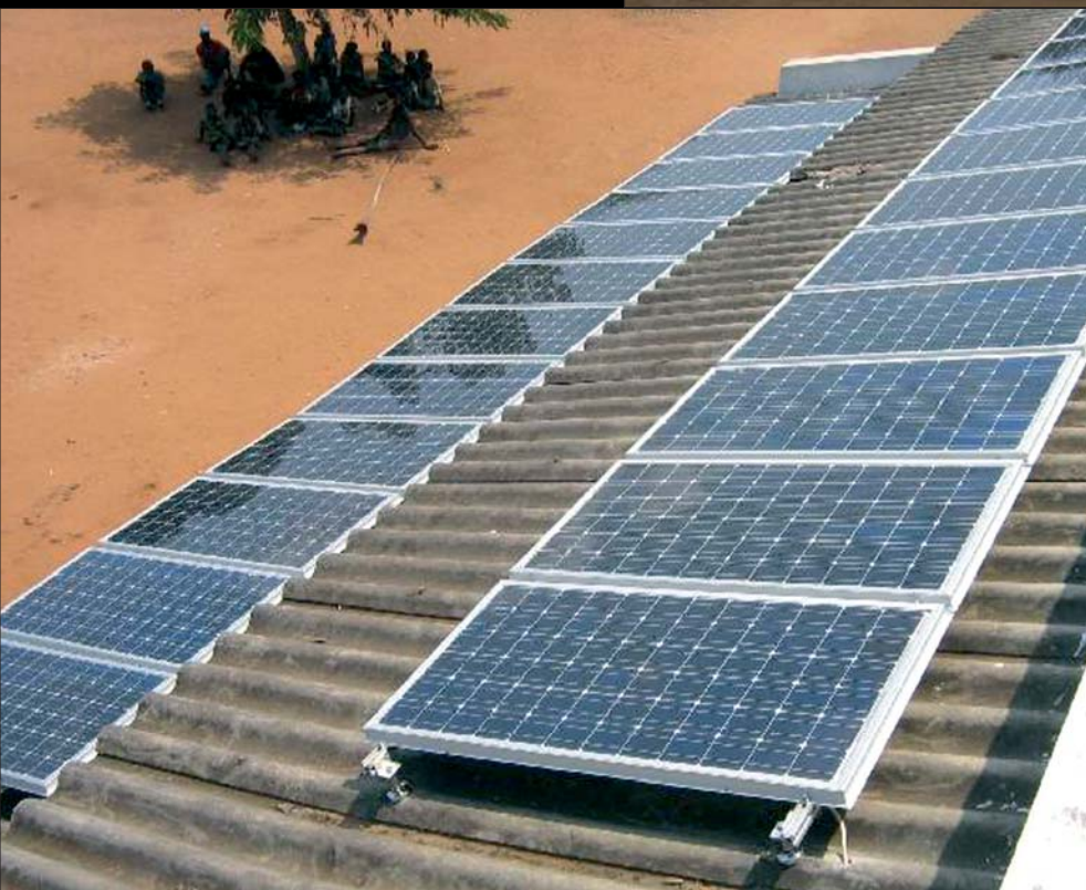
▼ Solárne kolektory na objekte nemocnice. Solar panels on the hospital. Solarzellen auf dem Gebäude des Krankenhauses
