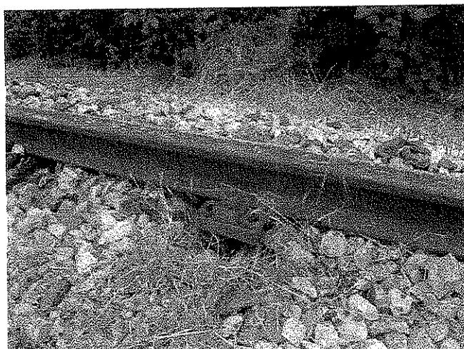
Obr. 6 Zlý stav podvalov a chýbajúce skrutky
