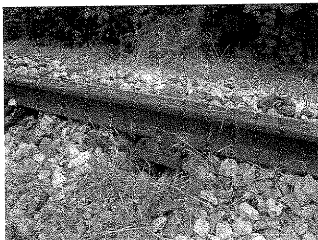
Obr. 6 Zlý stav podvalov a chýbajúce skrutky
